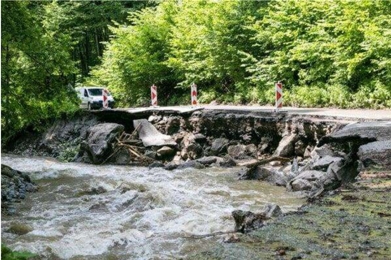
Obr. 6.2. Dôsledky extrémnych zrážok. V júni 2020 intenzívna búrka na Gemeri strhla kus cesty č. II/531 na úseku Muráň – Predná Hora (Zdroj: BBSK, 2020)
